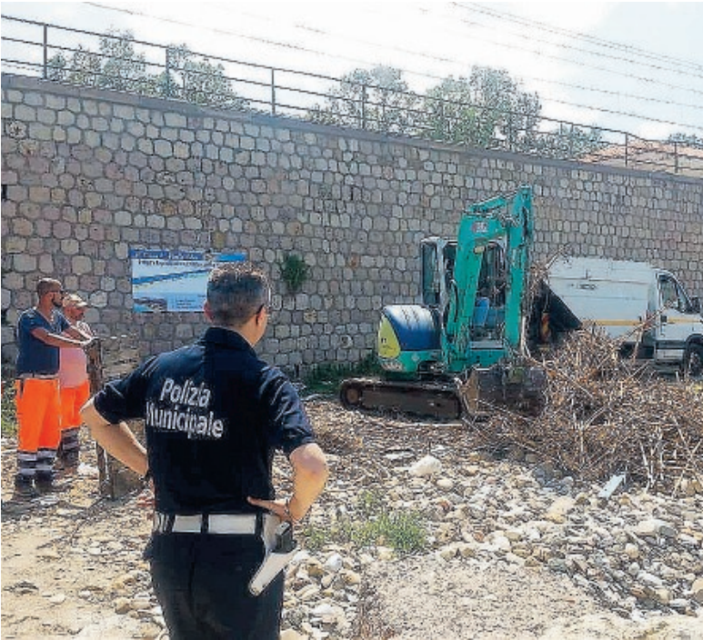
Sospetto amianto. La zona di contrada Marina del Ponte (*FOTO PIG*)
